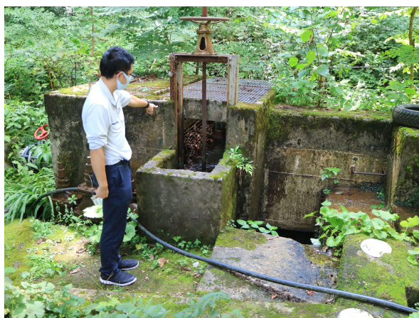
写真 5-3 取水している防火用水
