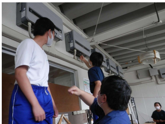
写真 4-3 パワーコンディショナーの自立 運転の切り替え方を説明している様子。 写真提供：おひさま進歩エネルギー㈱
